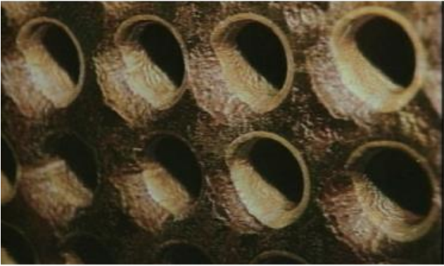
입구 부식 (Inlet Erosion)
